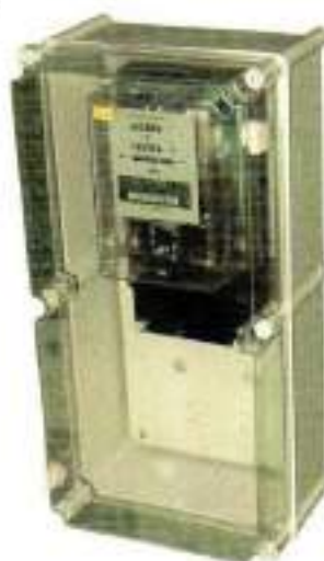
Caja sin interruptor automático
